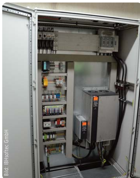
Bild 4: Einer der 39 Schaltschranke
