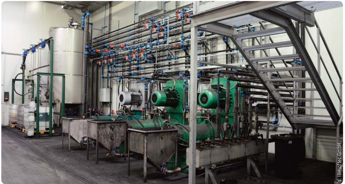
Bild 1: Rohmischungstank mit Rührwerkskugelmühlen M100.1 bis M100.3
